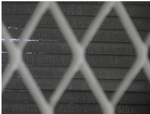
△ Before cleaning : tube 열 사이로 빛이 통과 되지 못함
