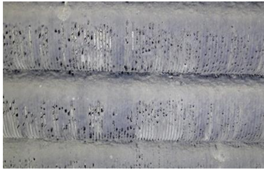
1. 협잡물로 Fouling 된 fin tubes
