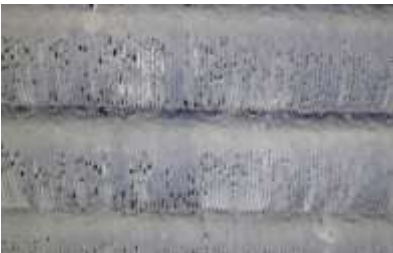
1. 협잡물로 Fouling 된 fin tubes
