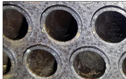
Tube pigging 후 스케일이 잔류된 모습
