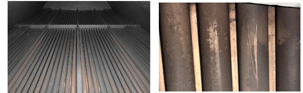
✓ Shell side의 튜브 외벽에 청수(냉각수) 스케일이 deposition 된 상태
