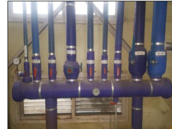
냉각수 배관 manifold
