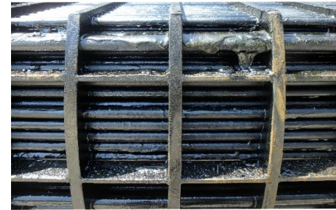
세정 대상 열교환기 bundle Heavy hydrocarbon Deposition
