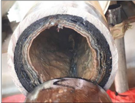
세정 전 스케일 형성 상태
