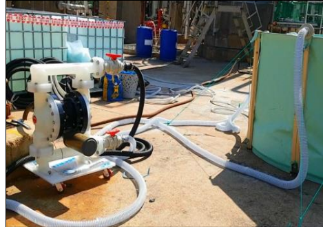
순환 세정 펌프 및 호스 연결
